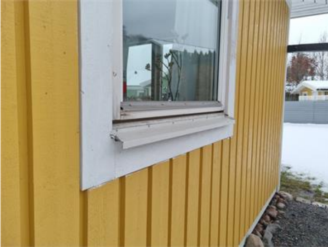
Bilden visar ett fönster med underhållsbehov.
