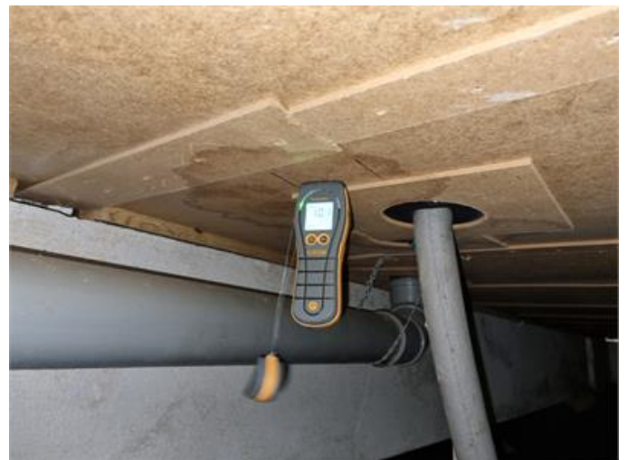
Bilden visar ett exempel på en fuktfläck i krypgrunden.
