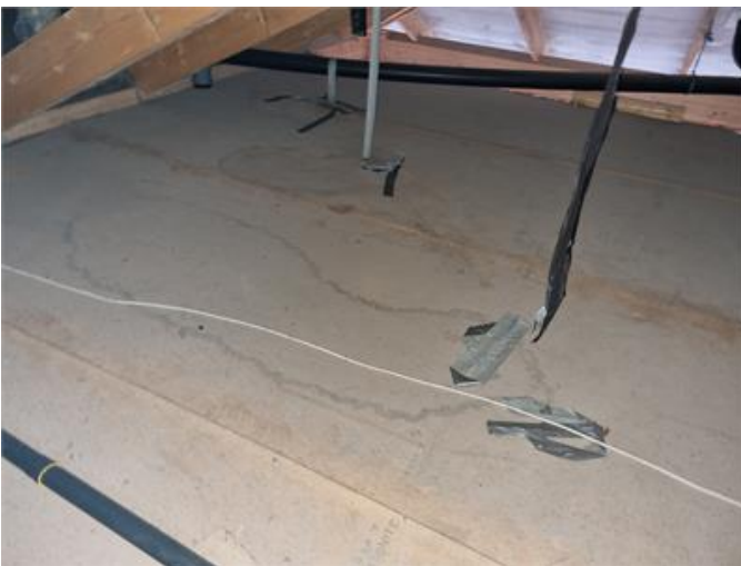
Bilden visar ett exempel på en fuktfläck i vindsutrymmet
