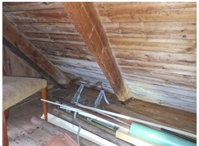
Nockvind, vitaktig mikrobiell påväxt i underlagstaket.
