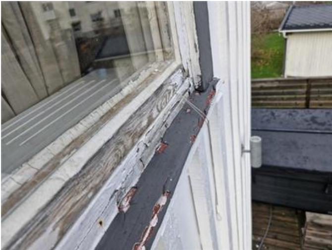
Fönster, äldre med färgsläpp överplan öster.
