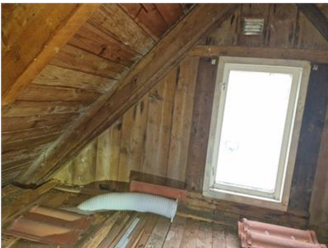
Nockvind, oisolerad ventslang från våtrum med utblås pånockvinden.
