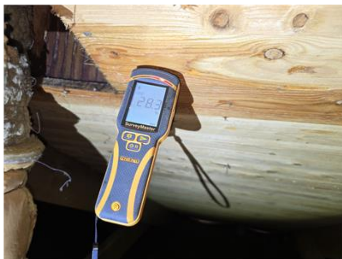
Nockvind: Fuktfläck/pågående inläckage vid ventilationshuv.
