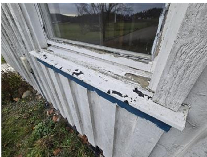
Fönster: Exempelbild på fönster med underhåll/bytesbehov.
