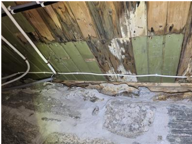
Grovkällare: Mikrobiell påväxt/missfärgningar på blindbotten, troligtvis från tidigare fuktskada.
