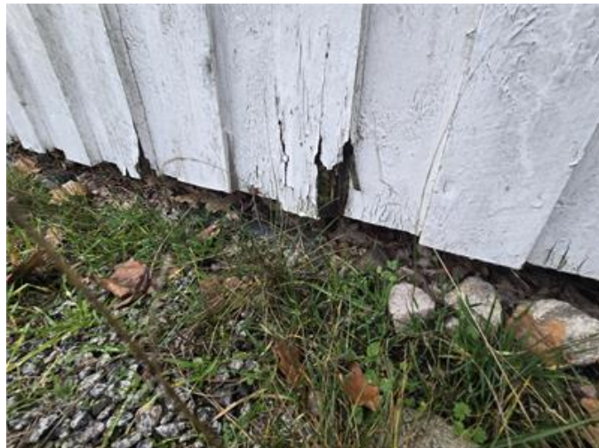
Fasad: Exempelbild på rötskadad panel.
