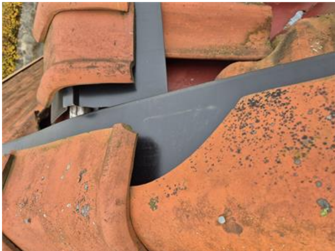
Bild från taknock med otäthet mellannockplåtar
