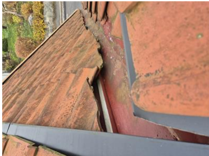
Bild från rännedal med oskyddad läkt vid plåtkant.
