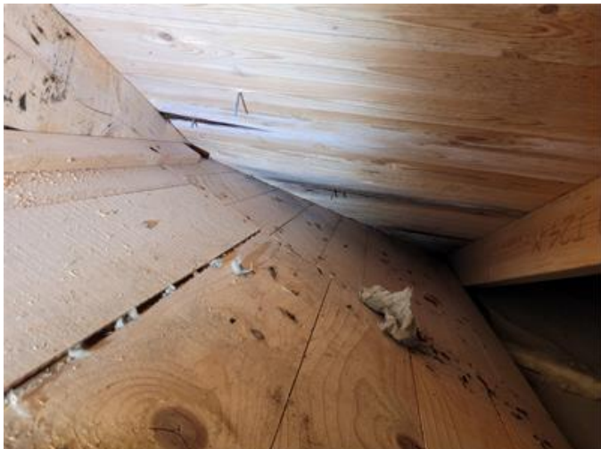
Läckage i yttertak.
