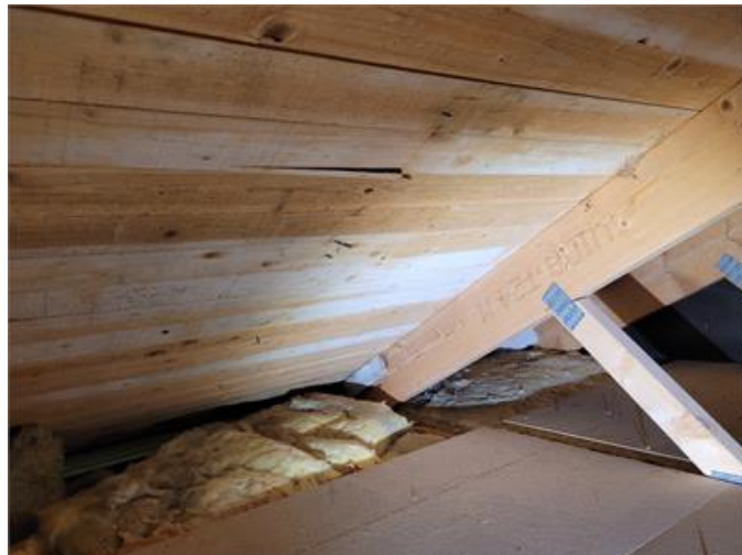
Mikrobiell påväxt på underlagstak.
