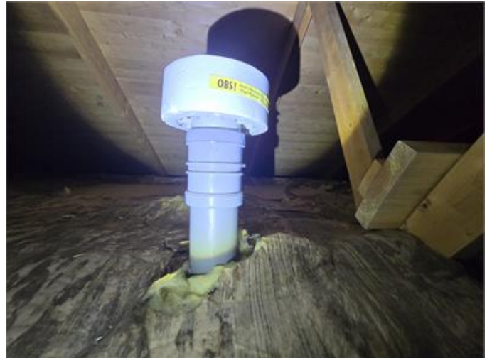
Nockvind: Avloppsluftare otät.
