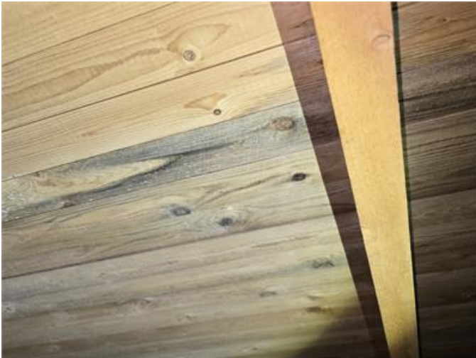
Nockvind: Missfärgning på underlagstak med något förhöjd fuktindikering.
