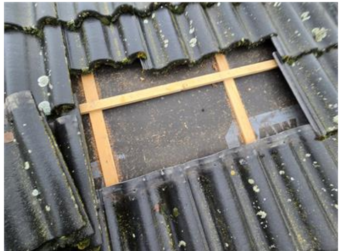
Tak: Stickprovskontroll under pannor, främjöl samt tunn ströläkt noteras.
