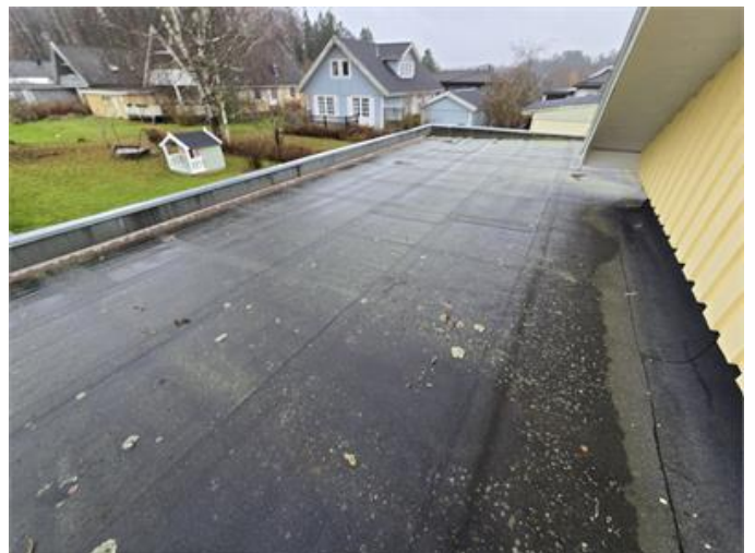
Tak Garage: Översiktsbild, mossa/alger noteras.
