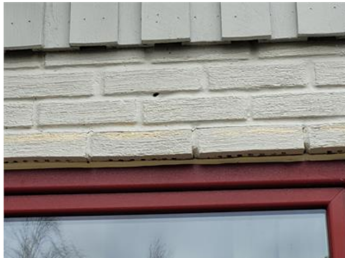
Tegel har släppt ovan fönster.
