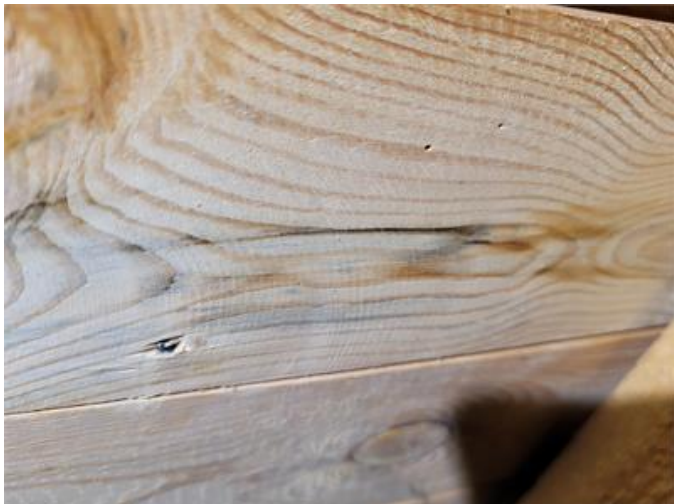
Fuktfleck på underlagstak.
