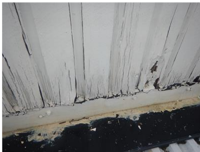
Rötskada i fasadpanel ovan altantak.
