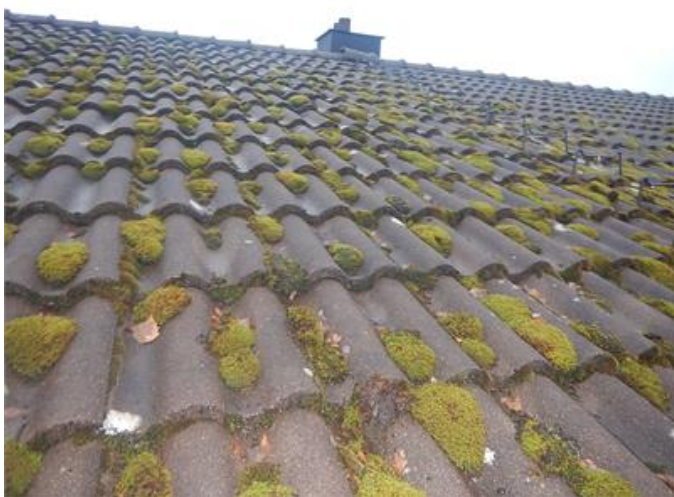
Mossa på takpannor.
