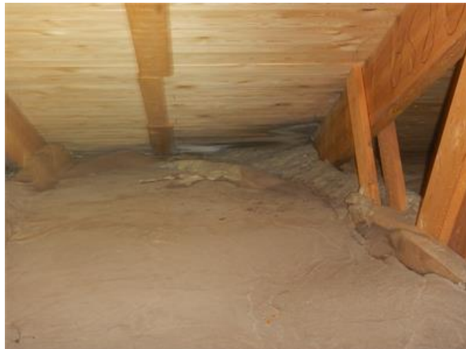
Mikrobiell påväxt på underlagstak.
