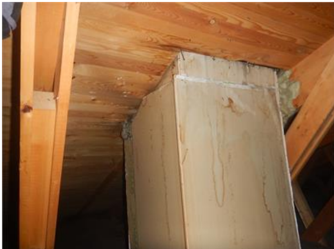
Fuktpåverkan på gipsschakt.
