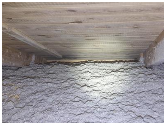
Nockvind, viss mörk mikrobiell påväxt i underlagstaket ner mot takfoten.
