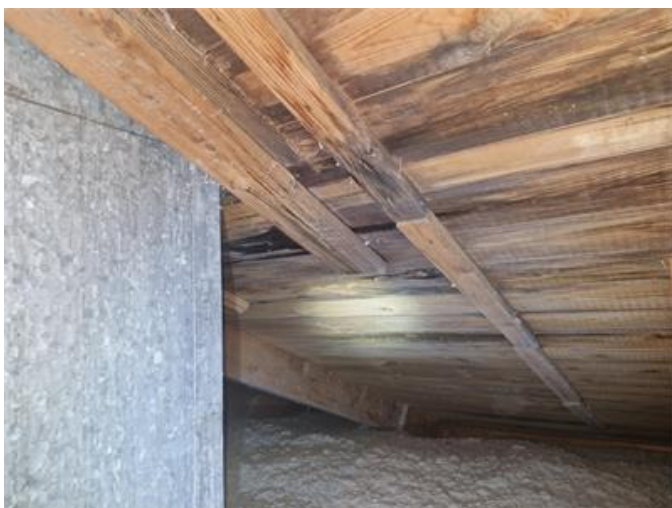
Nockvind, aktiv fuktanvisning nedan ventilationshuv.
