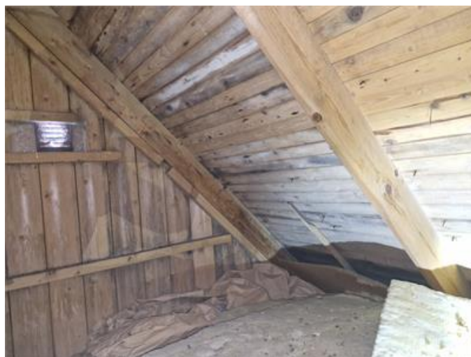
Nockvind bild mot norr, mikrobiell påväxt i underlagstaket och gavelplank.
