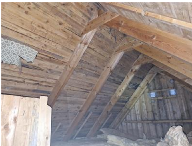
Nockvind bild mot söder, fuktgenomslag och mikrobiell påväxt i underlagstak och gavelplank.
