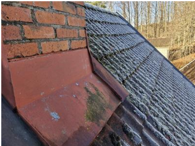
Tak, äldre med slitna pannor och mosspåväxt.
