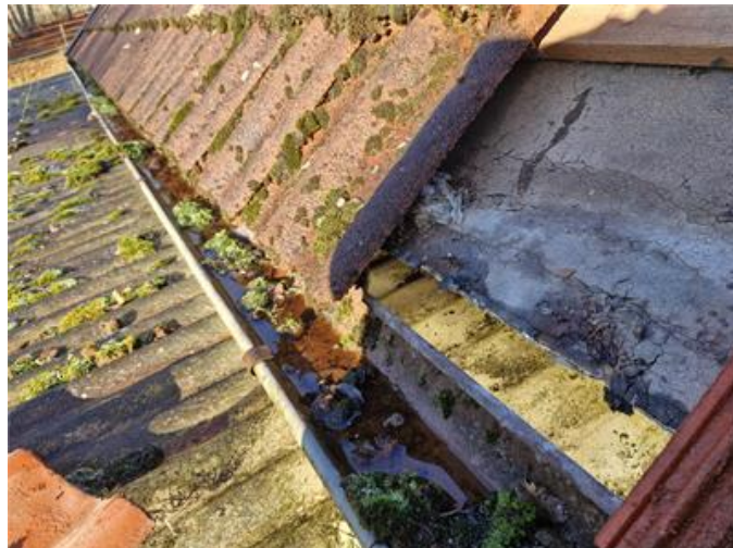
Tak, underlagspappen sliten, mossa i rännor.
