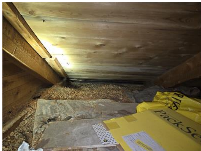
Exempel på mikrobiell påväxt på del av underlagstak.
