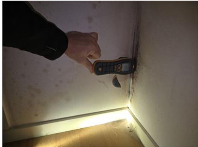
Exempel på påväxt/missfärgningar på gips.
