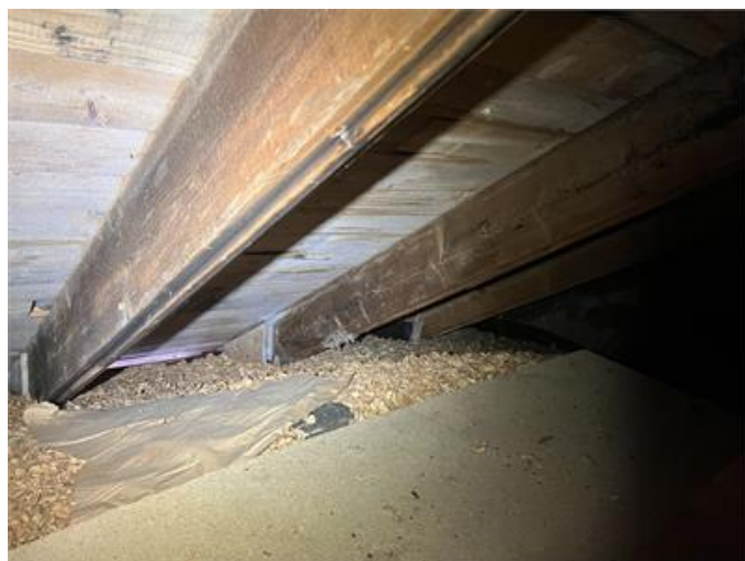
Rimfrost samt mikrobiell påväxt på sidovindar.
