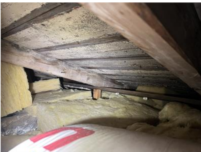
Rimfrost samt mikrobiell påväxt på vinden.
