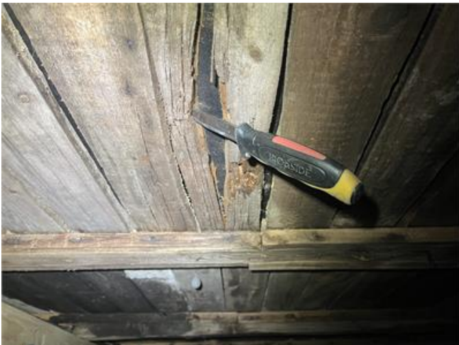
Mikrobiell påväxt samt rötskador förekommer i grunden.
