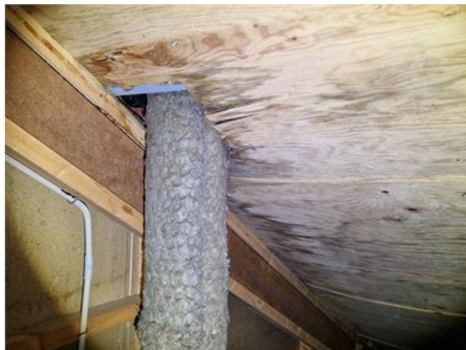
Vind: Fuktfläckar med förhöjda fuktvärden noterades i underlagstak vid rör genomföring.
