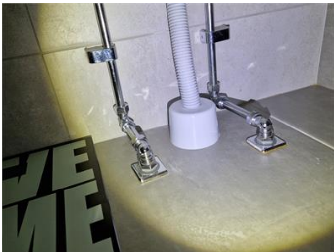
Dusch/Wc/Bastu: Rör genomföringar i golv
