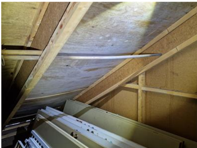
Vind: Mikrobiell påväxt förekommer på underlagstakets undersida.
