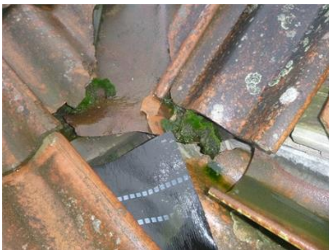
Lös pappbit ligger nedanför rännviden mot framsidan då pannor ej täcker underlagstaket
