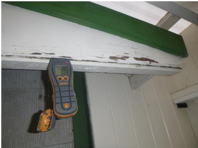
Läckage i taket mot groventrén vid uterummet
