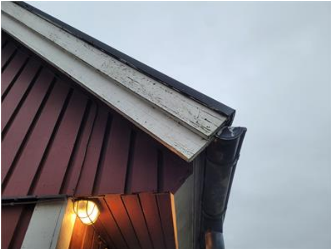
Underhållsbehov och lokala rötskador i vindskivor.
