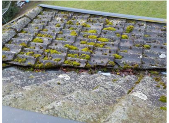
Spruckna takpannor och mossa på entréverandan.
