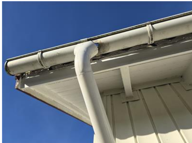
Exempel på anslutning mellan hängränna/stupspråk som är otät.
