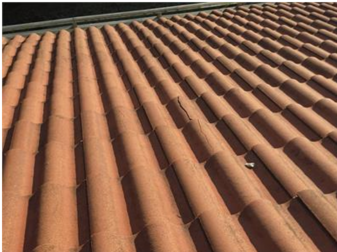
Exempel på spruckna takpannor.
