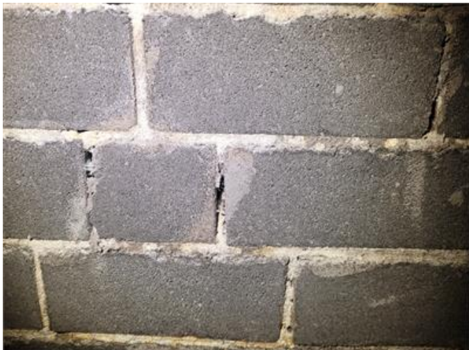
Kalkutfällningar på grundmurens insida.
