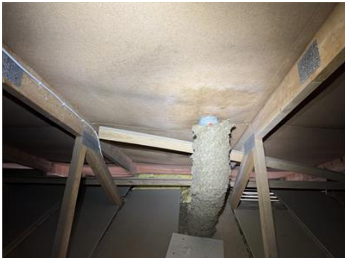
Exempel missfärgning/fuktfläck underlagstak vind
