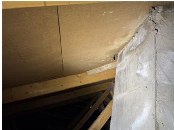
Exempel missfärgning/fuktfläck underlagstak vind
