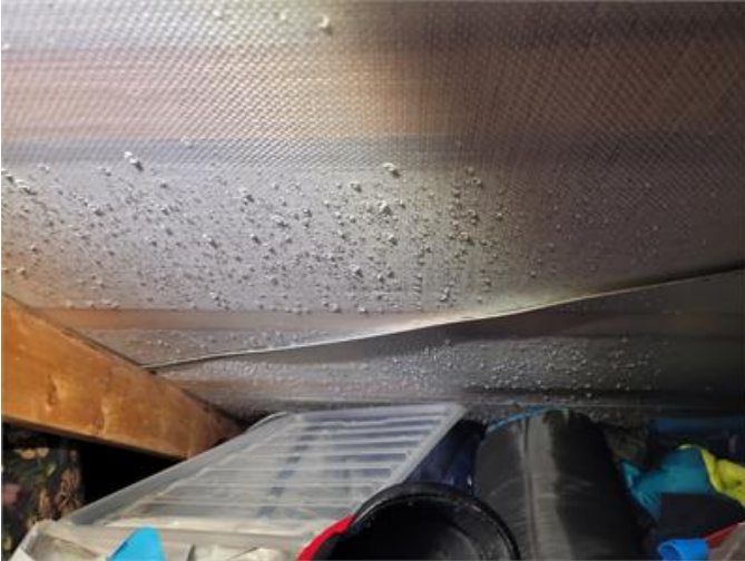
Rimfrost på insida underlagstak (Garaget)
