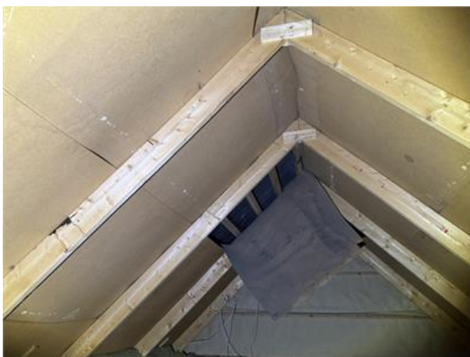
Underlagstak av masonitskivor har lokalt släppt i vindsutrymmet.
