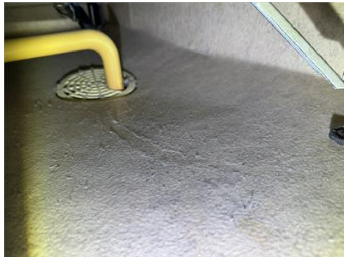
I WC/dusch har plastmattan släppt mellan golvbrunn och vägg.
