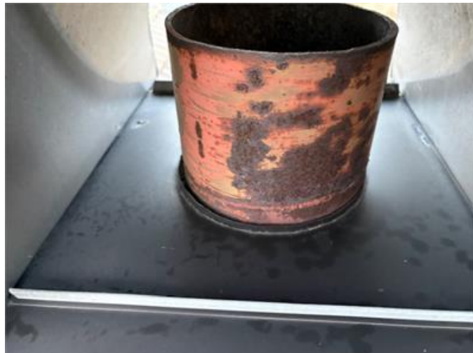
Bilden visar skorstensrör där tätning inte finns.
