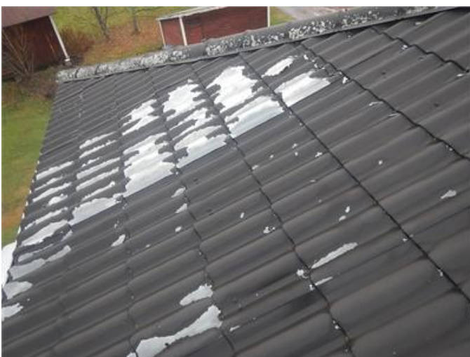
Färgsläpp på takplåtar.
