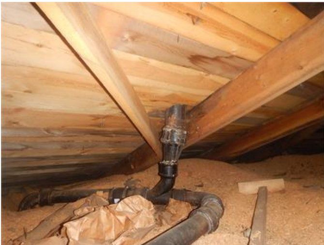
Fuktfläck på underlagstak vind.
