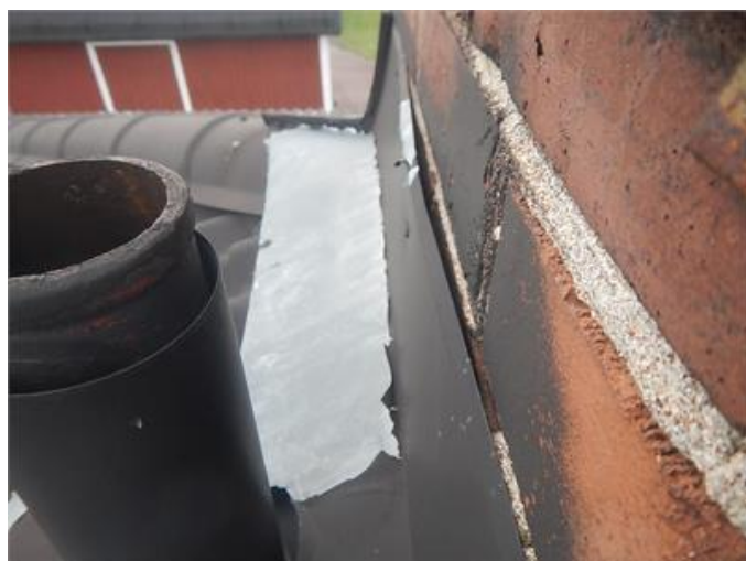
Otätthet mellan murstock och skorstensbeslag.
