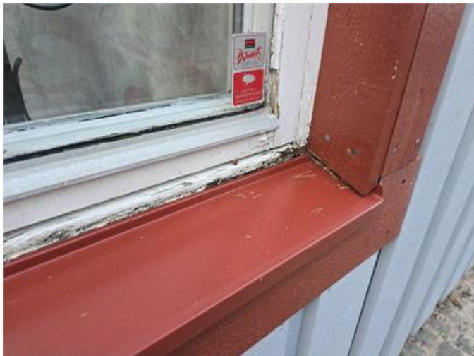
Exempelbild, rötskada fönster och otätt bleck.
