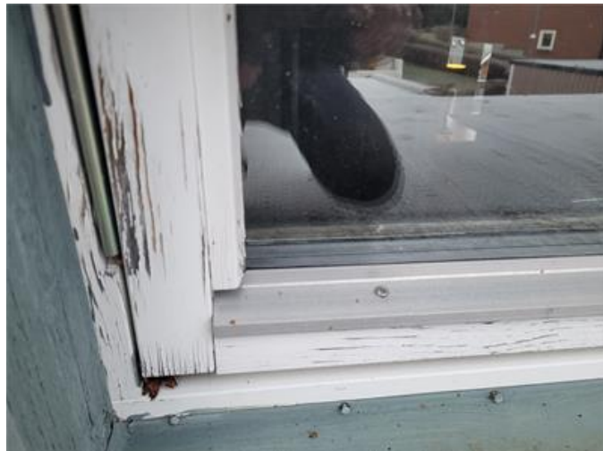
Fönster med underhållsbehov.
