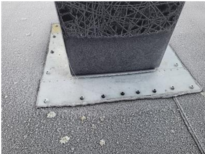
Papp saknas runt kaminrör.
