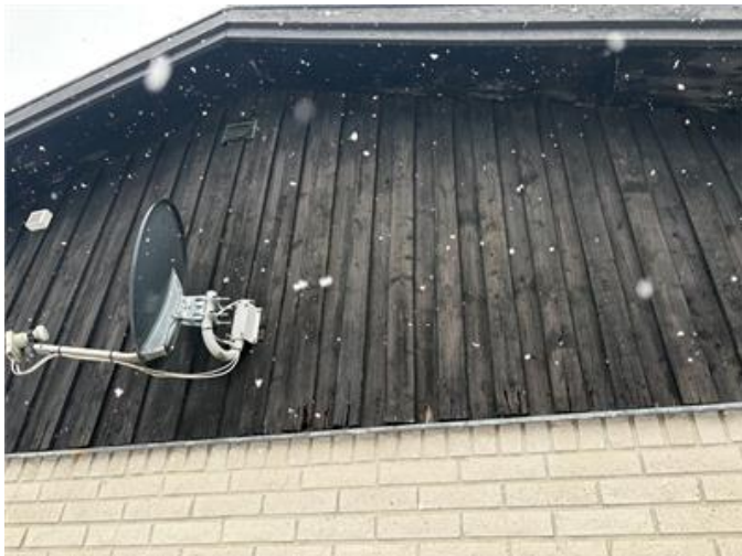
Beklädnadsbrädor/fasad med underhållsbehov.
