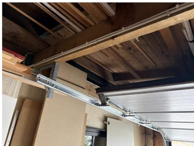
Spår förekommer till insida yttertak tillbyggt garage efter visst inläckage.
