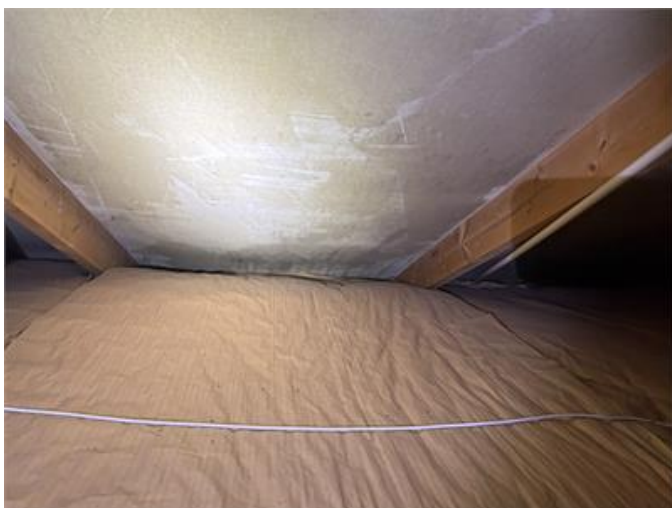
Lokal missfärgning insida yttertak vindsutrymme.
