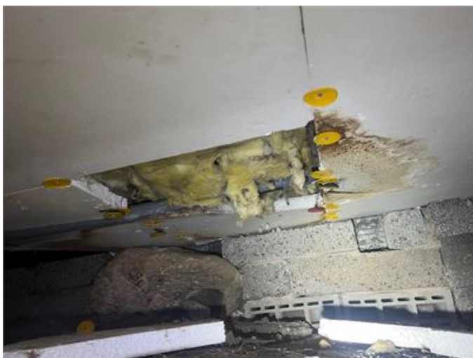
Exempel på fuktfläckar i blindbotten i krypgrunden.
