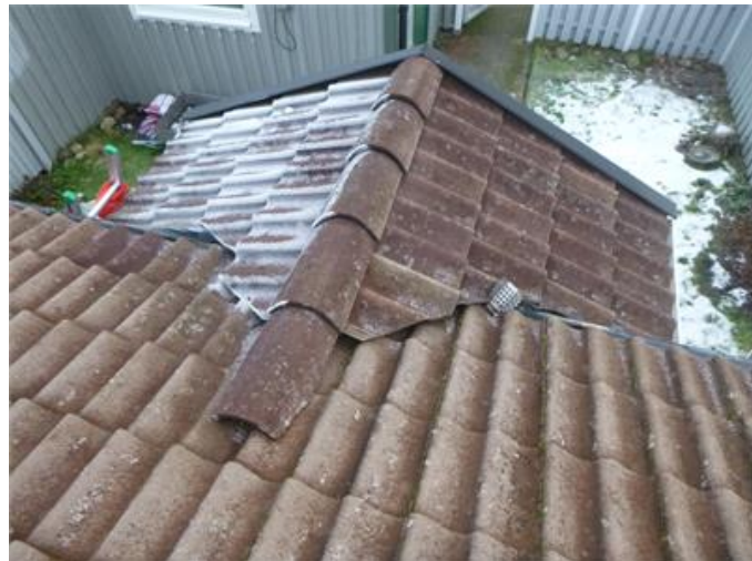
Vinkelrännor saknas mot verandans tak
