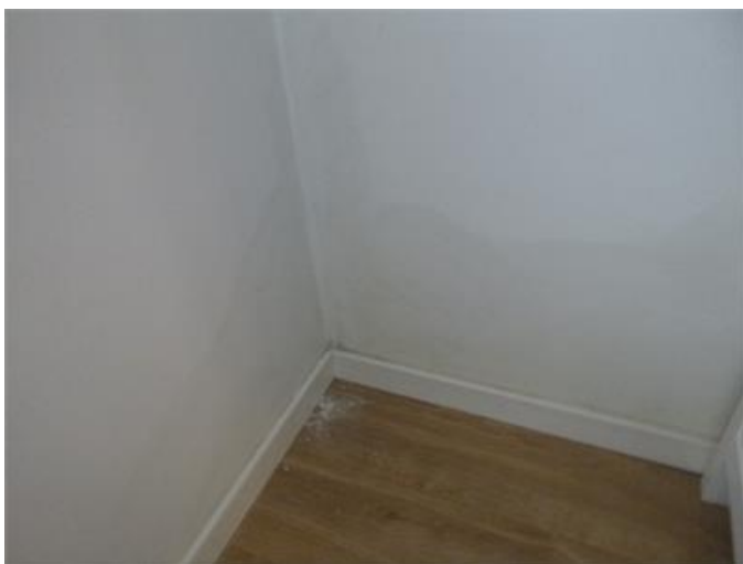
Fuktfläck på vägg i vardagsrum
