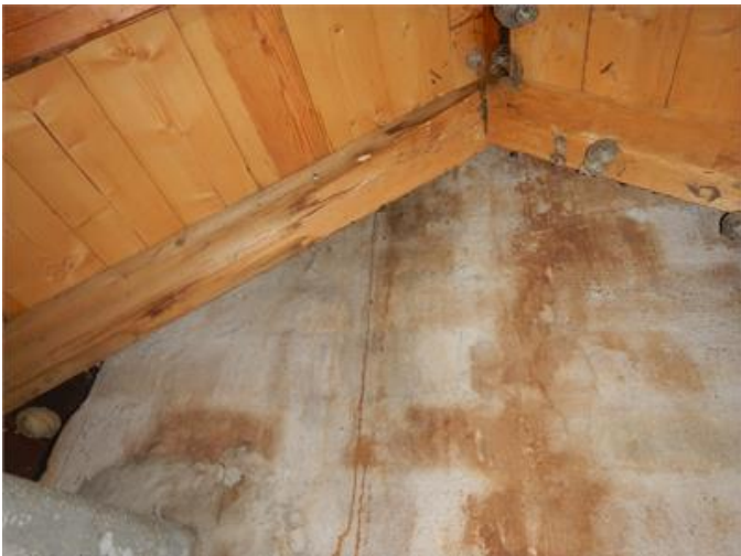
Fuktpåverkan på murstock vind.
