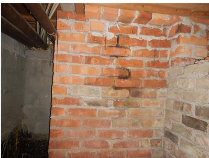
Otätthet i murstock med sotläckage.
