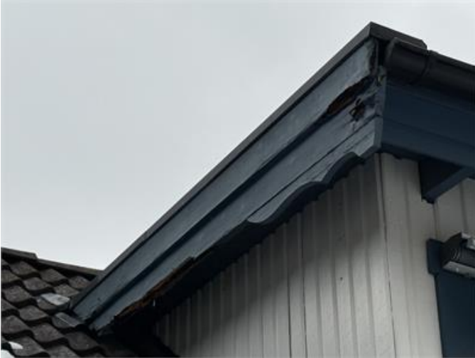
Fasad/beklädnadsbrädor med underhållsbehov.
