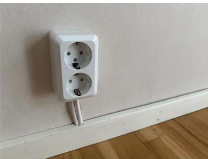
Husets elinstallationer rekommenderas att kontrolleras då brister har noterats. Jordade uttag utan framdragen jord noterades i bland annat vardagsrum och kontor.
