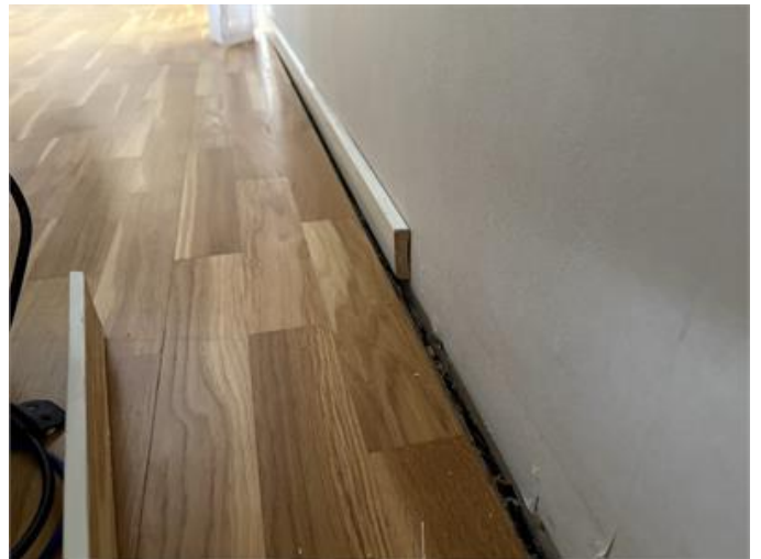
I vardagsrum noterades glipa mellan golvkonstruktion och yttervägg vilket indikerar på sättning.
