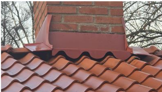
Exempelbild, otätheter mellan takpannor/plåtarbeten.
