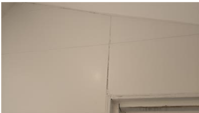
Exempelbild, spricka i vägg, dusch/wc/tvätt.
