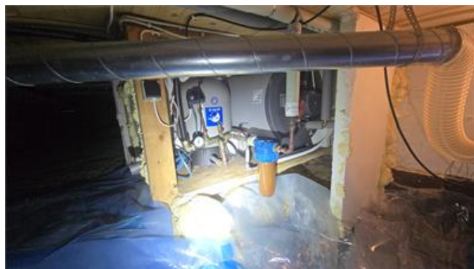
Vatteninstallationer i krypgrund.
