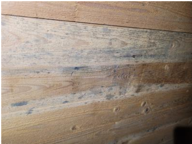
Mikrobiell påväxt på underlagstak.
