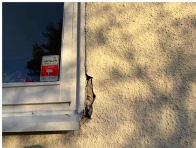
Det förekommer putsbom/putsläpp och sprickor i den äldre delen av den putsade fasaden. Putslagningar kan förväntas löpande behövas utföras i äldre fasader.
