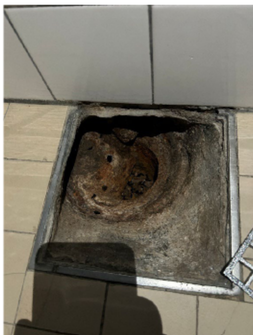
Äldre typ av golvbrunn med klämring
