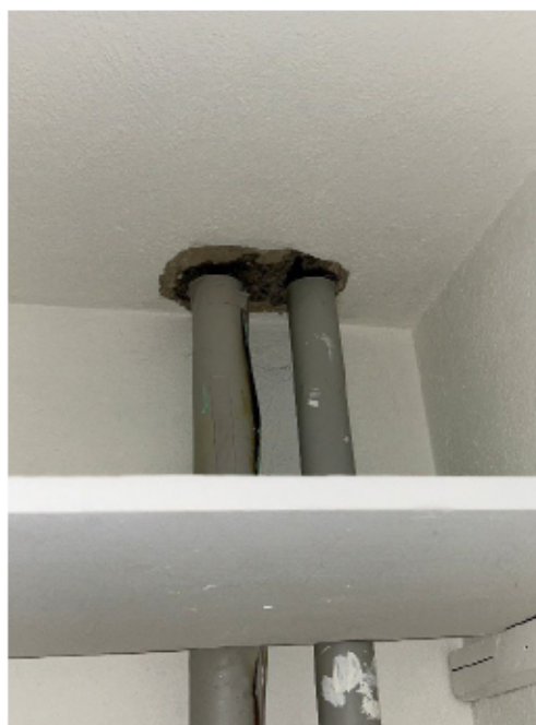
Tappvattenrör i klädkammare, misstänkt ej brandtätat
