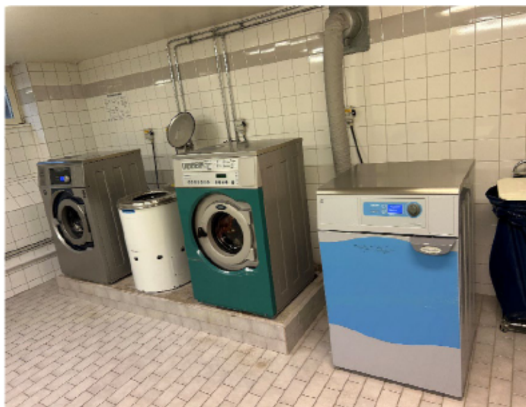
Tvättstuga med maskiner från Electrolux
