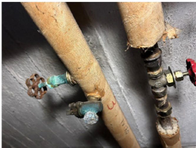
Ventiler på värmesystemet med olika ålder
