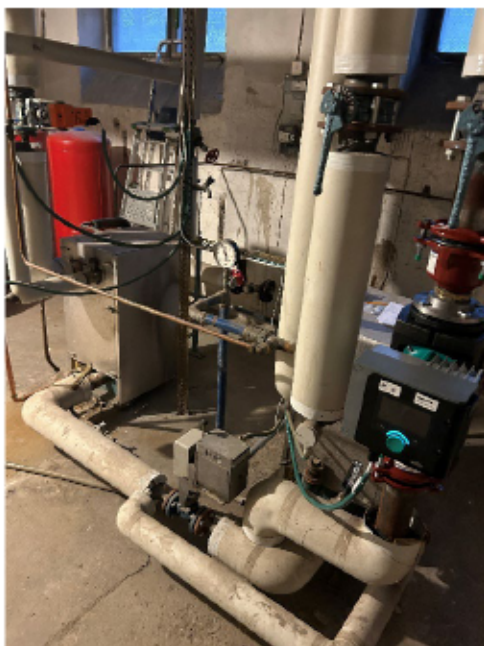
Fjärrvärmväxlare i källaren
