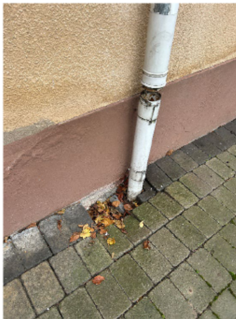
Underminerad mark i samband med stuprör
