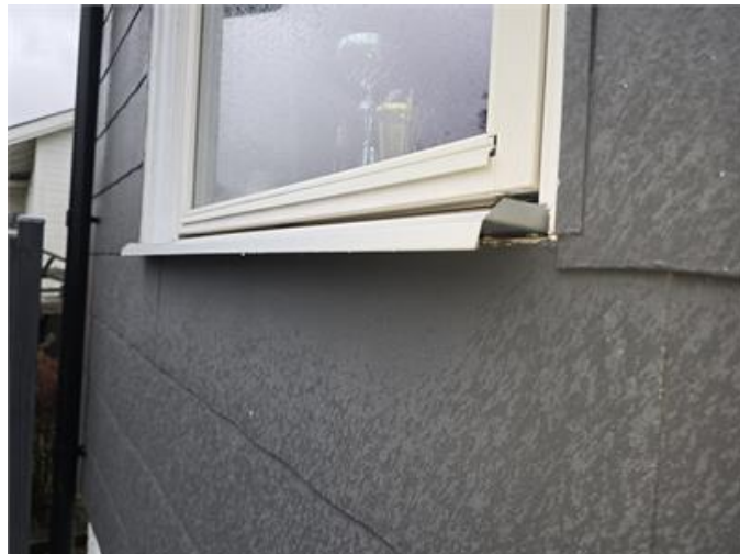
Exempel på fönsterbleck med bristfällig lutning.
