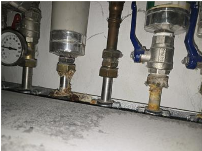
Rostangrepp i rör/kopplingar ovan fjärrvärmecentral.
