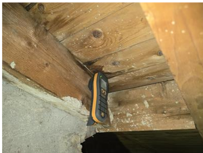
Exempel på fuktfleck på vinden.
