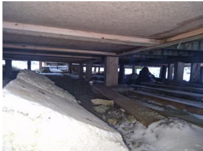
Plintgrund. Altan ligger dikt an fasad och belastar intilliggande konstruktioner.
