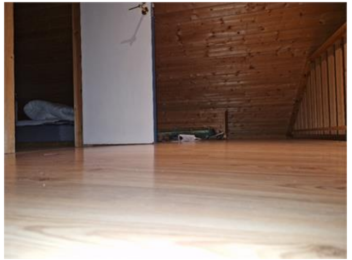
Sättningar noteras på loft.
