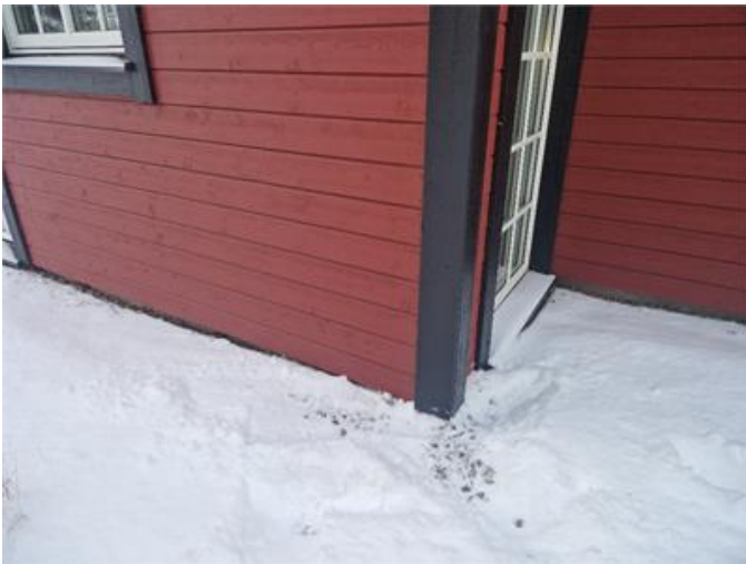
Delar av fasad är marknära
