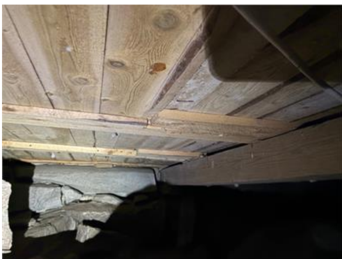
Lokalt i grunden förekommer mindre mängd mikrobiell påväxt på undersidan av bjälklaget.
