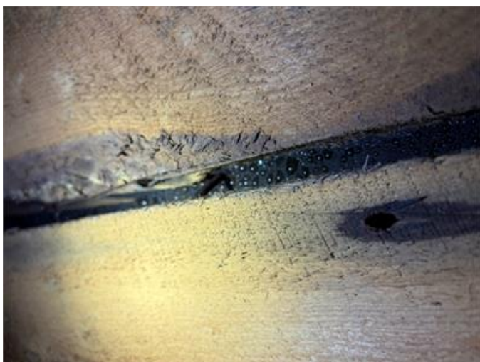
Vid luckan noterades kondens på undersidan av tjärpappen
