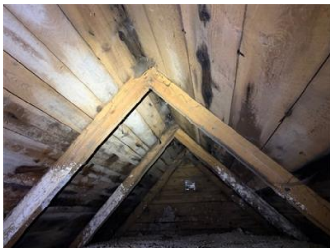
Vid luckan noterades kondens på undersidan av tjärpappen samt missfärgningar som indikerar på att varm luft från boendemiljön stiger upp mot vinden.
