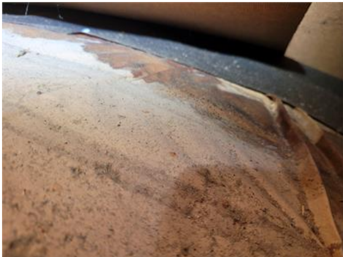
Fuktfläckar på isoleringsskivor
