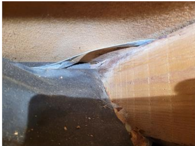
Mikrobiell påväxt och fuktfläckar på takstol & underlagstak
