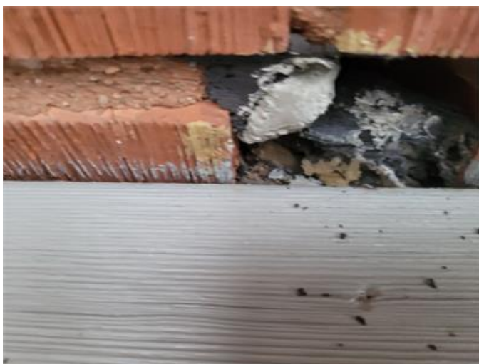
Otättheter mellan fasad och balkongens bärlina.
