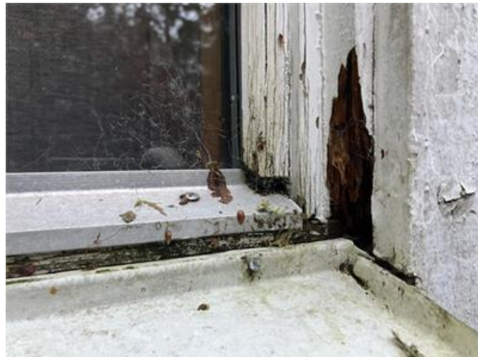
Rötskada i fönster
