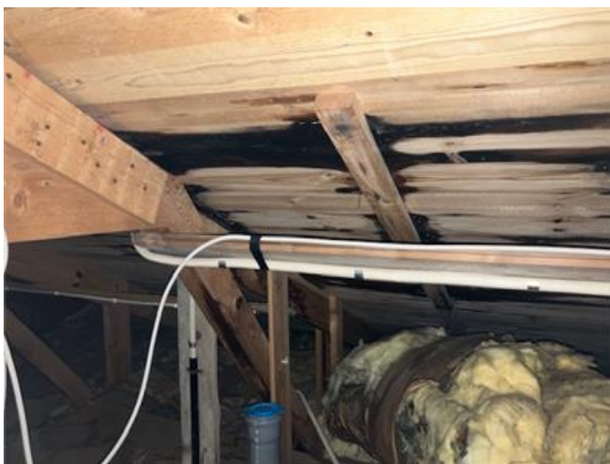
Fuktgenomträngning i yttertaket på vinden
