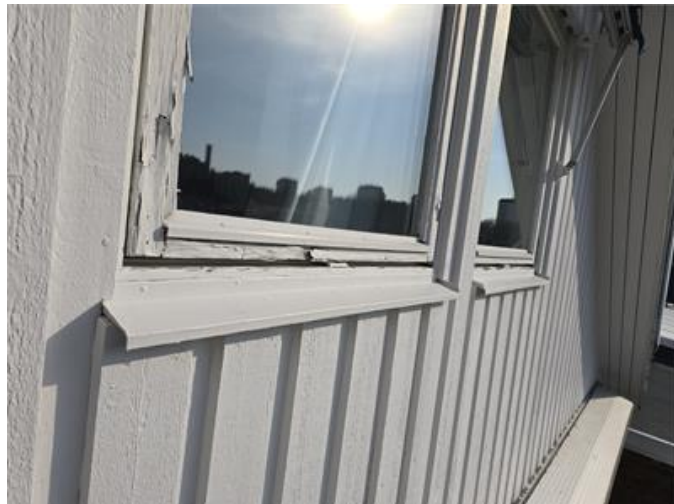
Bilden visar exempel på fönster med underhållsbehov.
