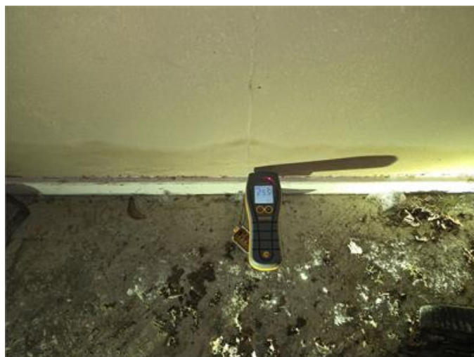
Missfärgning på vägg i förråd, förhöjda fuktindikationer har noterats i väggens nederkant.
