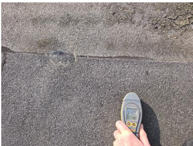
Fuktindikering på papptak med förhöjda indikationer.
