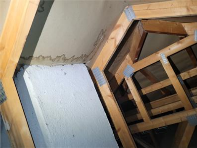
Fuktfläckar på underlagstak
