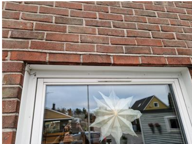
Fasad: Spruckna trasiga fogar förekommer, främst ovan fönster.
