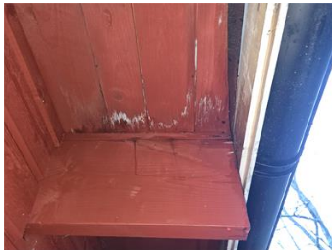
Tak: Nederkant råspons mot söder har pågående läckage.
