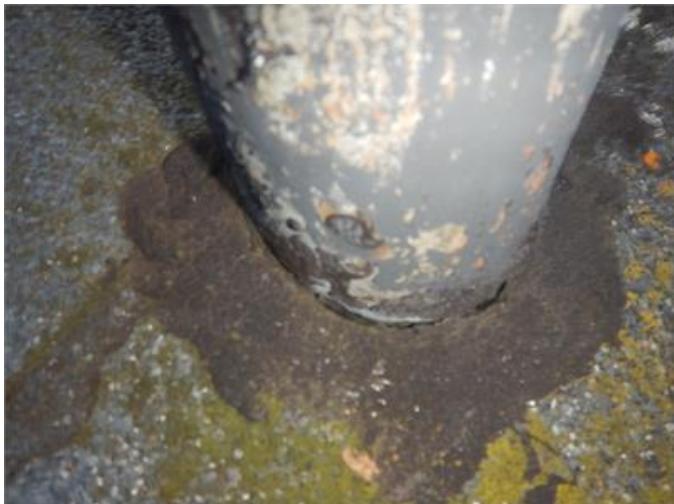
Otätthet mellan papp och avloppsventilation på tak.
