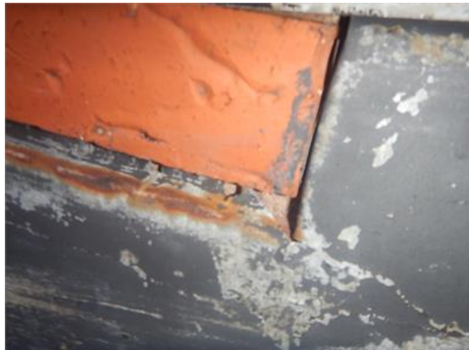
Exempel på otätthet mellan plåt och murstock.
