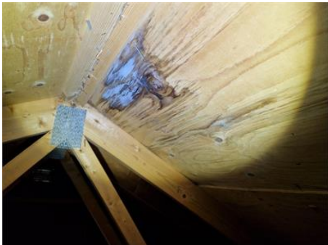
Vind: Fuktgenomslag med förhöjda fuktvärden.
