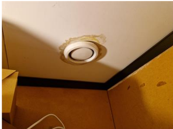
Klädkammare: Fuktfläckar förekommer i innertak i anslutning till ventilationsdon.
