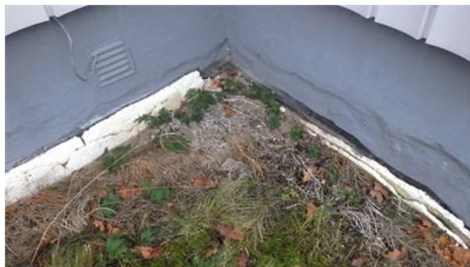
Synlig isolering på källarväggen där det inte finns någon täcklist
