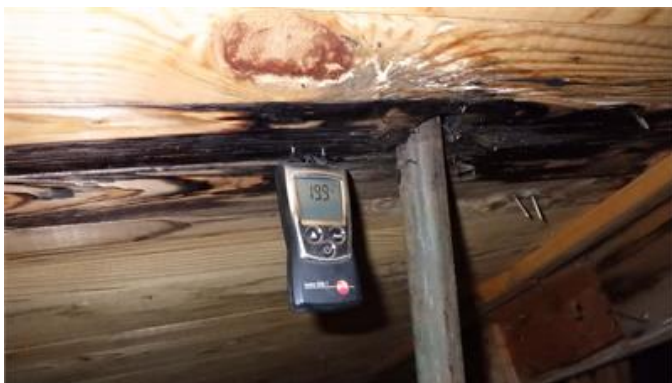
Fuktgenomslag i yttertaket på vinden
