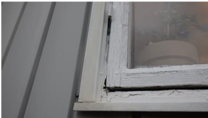
Fönster med underhållsbehov samt otät infästning
