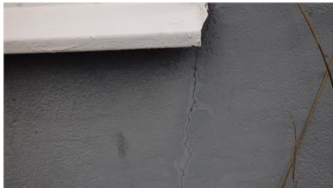
Spricka i sockeln
