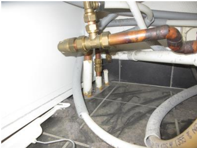
Rör genomföringar i våtrumsgolv
