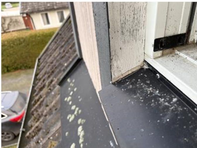
Fönsterbleck utan uppvik.
