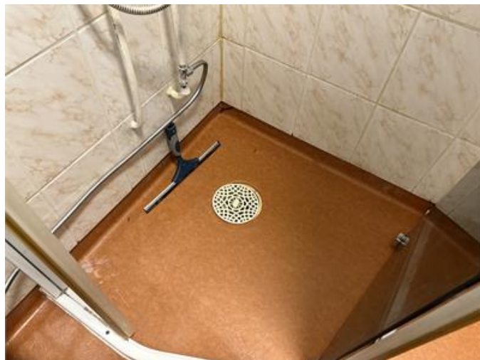
Dusch/wc entréplan bedöms ha ett relativt närliggande renoveringsbehov.
