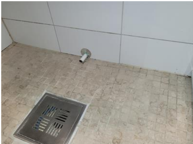
Rör genomföring i dusch.
