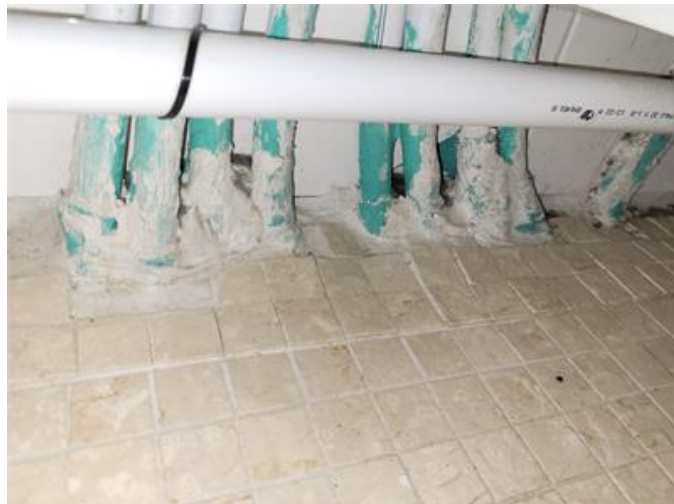
Rör genomföringar i golv nära vägg.
