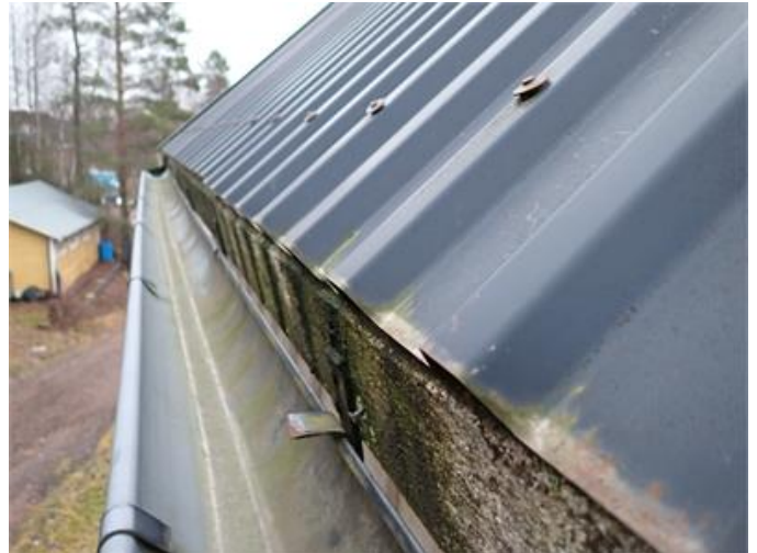
Exempel på där takplåtar inte täcker takfotsbräda samt avsaknad av takfotsplåtar.
