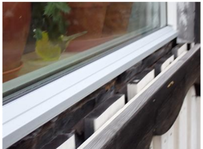
Exempel på där fönster saknar foder, salning och fönsterbleck.
