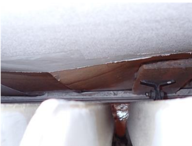
Fuktfleck och bulig väggskiva bakom radiator i sovrums på entréplan.
