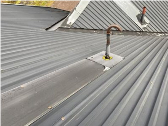
Bilden visar otätheter invid rörgenomföring på taket.
