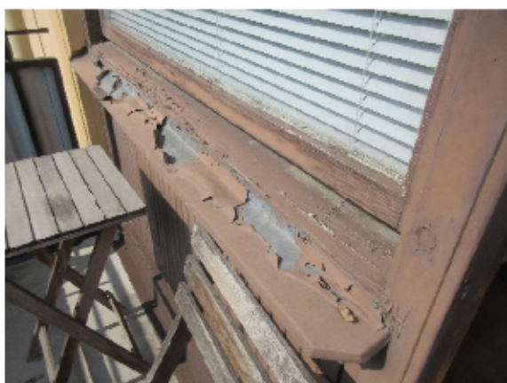
Fönster mot gatan i dåligt skick
