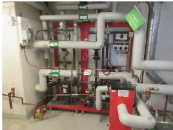
Undercentral för värme och tappvarmvatten.
