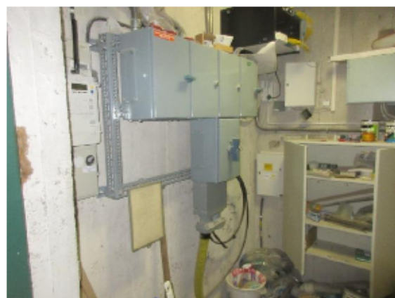
Elektriska installationer från ca 1985.
